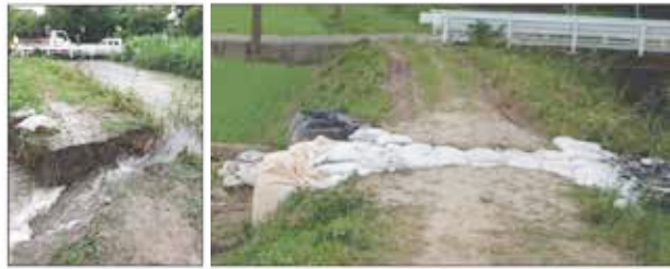
三宅川の池部側が破堤 県による 仮復旧
